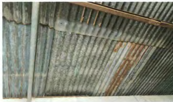
Foto 2: Sustrucción de cubierta de lámina y estructura de techo en módulo 6 por deterioro de los materiales.
